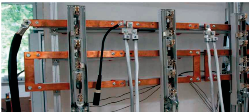
fot. 11. Badanie trzech rozłączników z zaciskami piętrowymi typu V (z nową przekładką)
